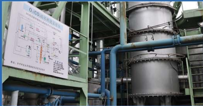
400kWt富氧循环燃烧装置
