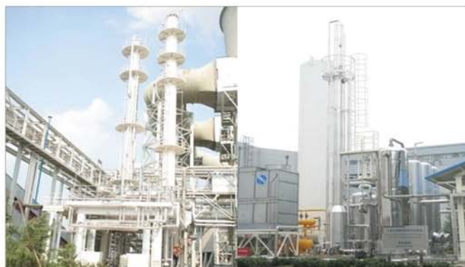
华能北京热电厂3000吨/年CO 2 捕集试验装置
