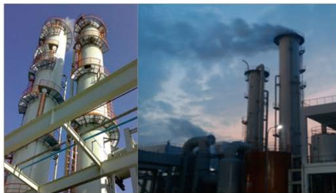
华能上海石洞口第二电厂10万吨/年CO 2 捕集示范项目
